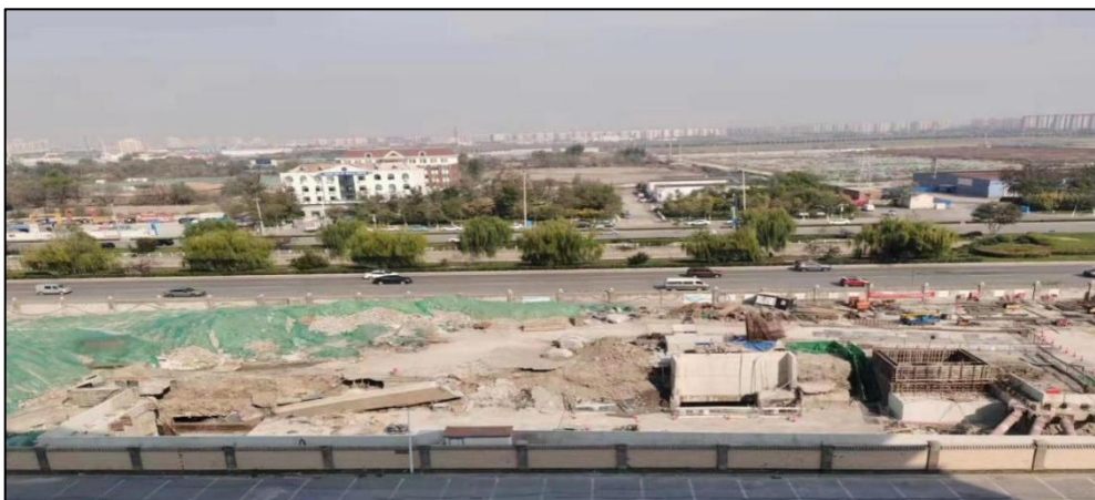
图3 事发地点A2出入口与车站连接口和新风井全貌
