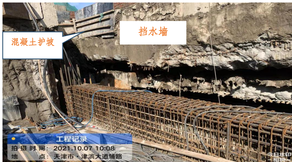
图 5 坍塌前护坡、挡水墙原状
